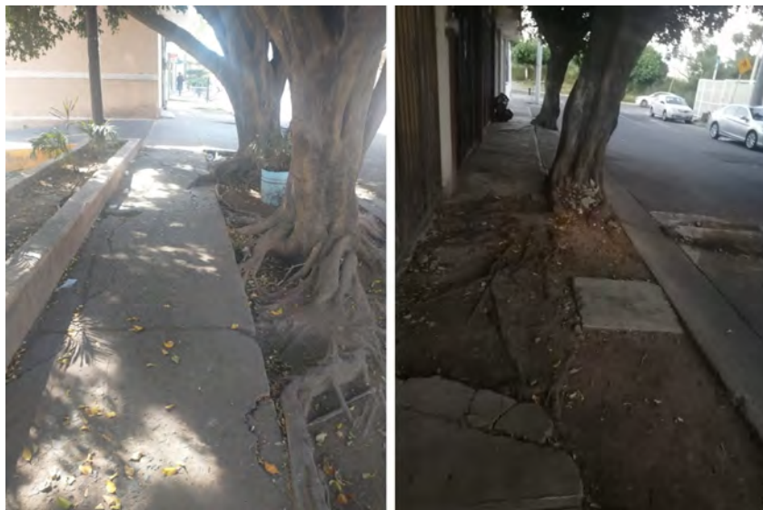
Figura 4. Banquetas en mal estado
