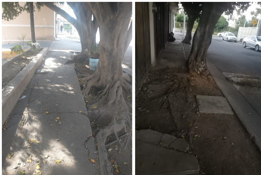
Figura 4. Banquetas en mal estado
